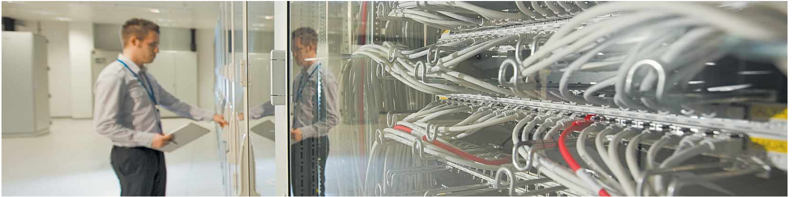
ALLE AN EINEM DRAHT Beim sogenannten Pooling im Rechenzentrum von T-Systems teilen sich Hunderte Server die Kapazitäten
